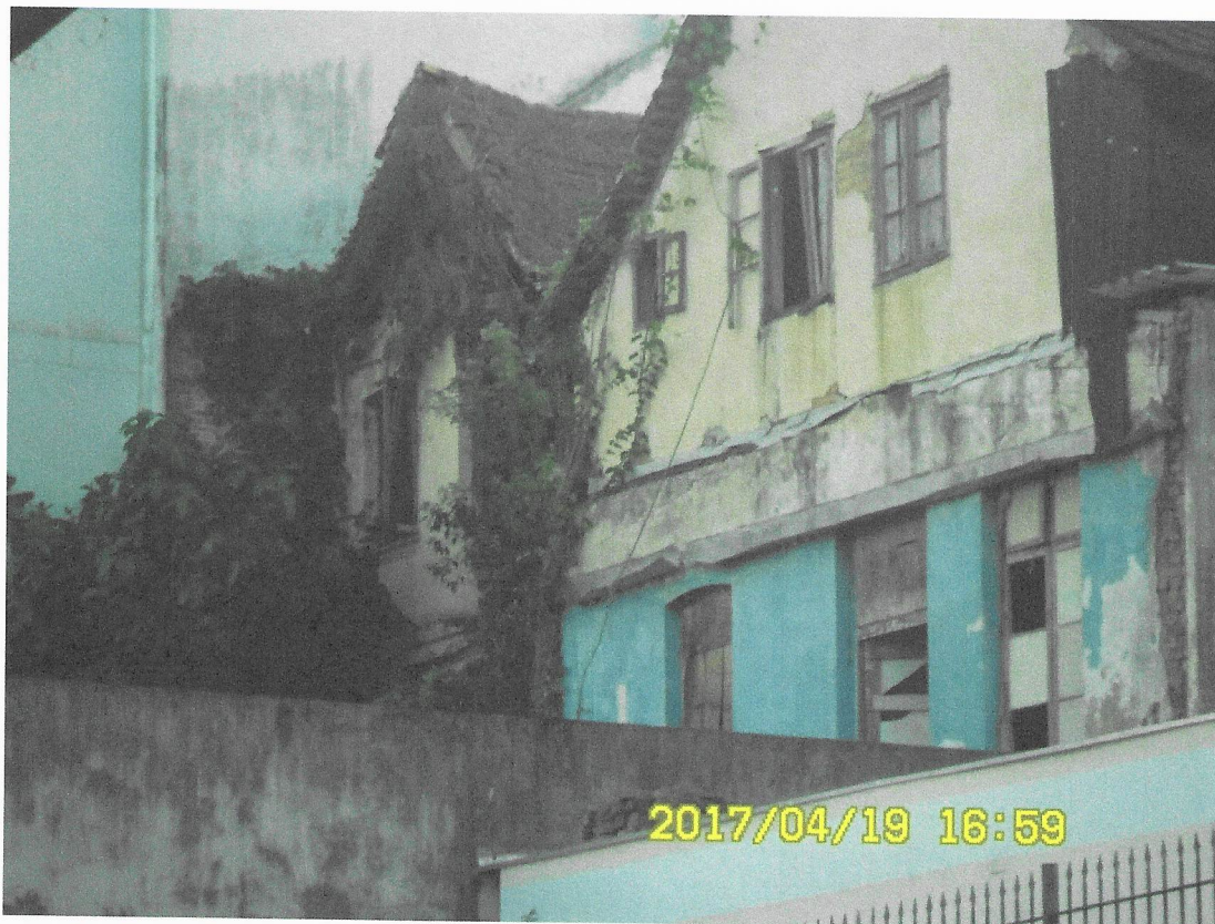
Figura 8 – Elevação Posterior, em seu estado de conservação atual, com muitas avarias, mas ainda possuindo total possibilidade de recuperação. (Fonte: Arquivo da Fundação Catarinense de Cultura- FCC)
