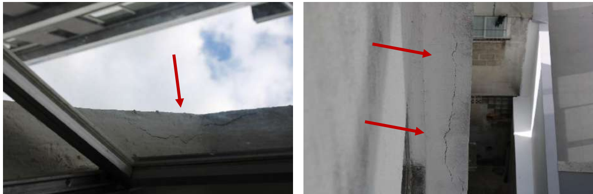
Figura 17 – Fissuras características de processos de corrosão nos pilares situados nas fachadas oeste e sul da edificação, respectivamente.
