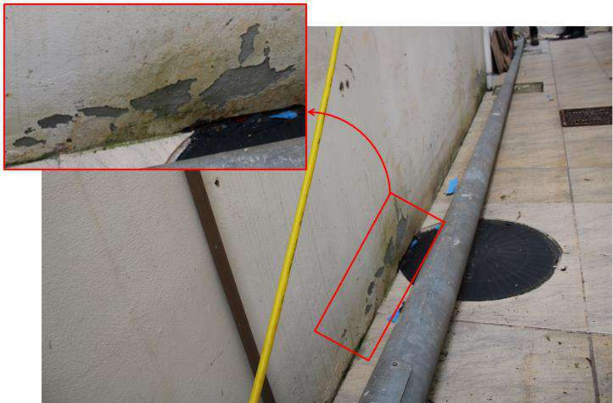
Figura 15 – Empolamento e descolamento da pintura observado na fachada oeste.
