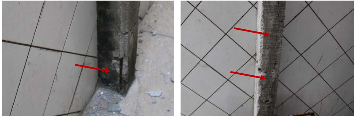
Figura 18 – Armadura exposta e fissura característica de processos de corrosão nos pilaretes do muro de divisa dos fundos.
