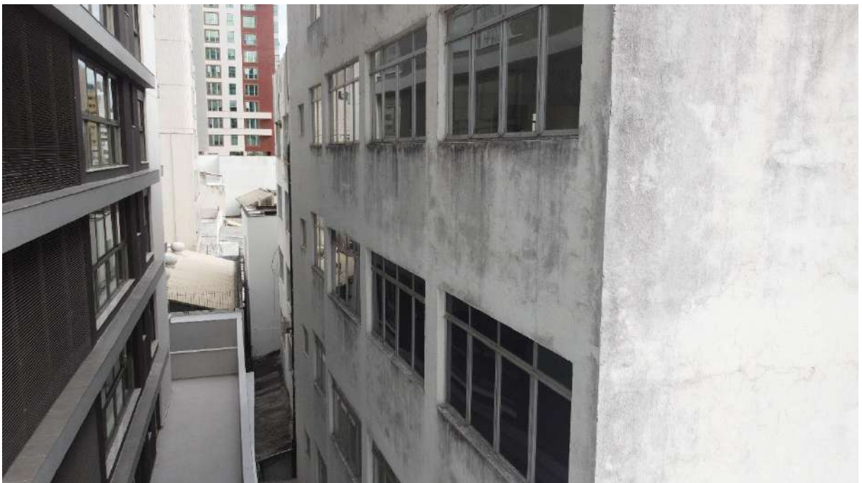
Figura 14 - Vista da fachada sul. Nota-se a elevada biodeterioração da pintura, caracterizada pelo manchamento da fachada. Esta anomalia se deu por falta de manutenções no sistema de pintura, sendo agravada pela ausência de pingadeiras sob as esquadrias, permitindo a percolação da água diretamente sobre a superfície pintada.
