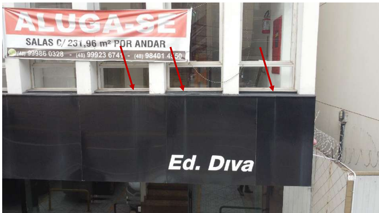
Figura 16 - Manchas de escoamento ocasionadas pela percolação de água através das frestas nas regiões de emenda das pingadeiras, cuja calafetação encontra-se deficiente.
