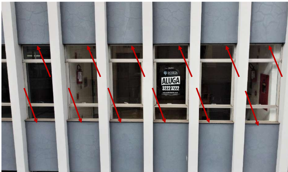
Figura 9 – Fissuras mapeadas por toda a extensão da fachada norte.
