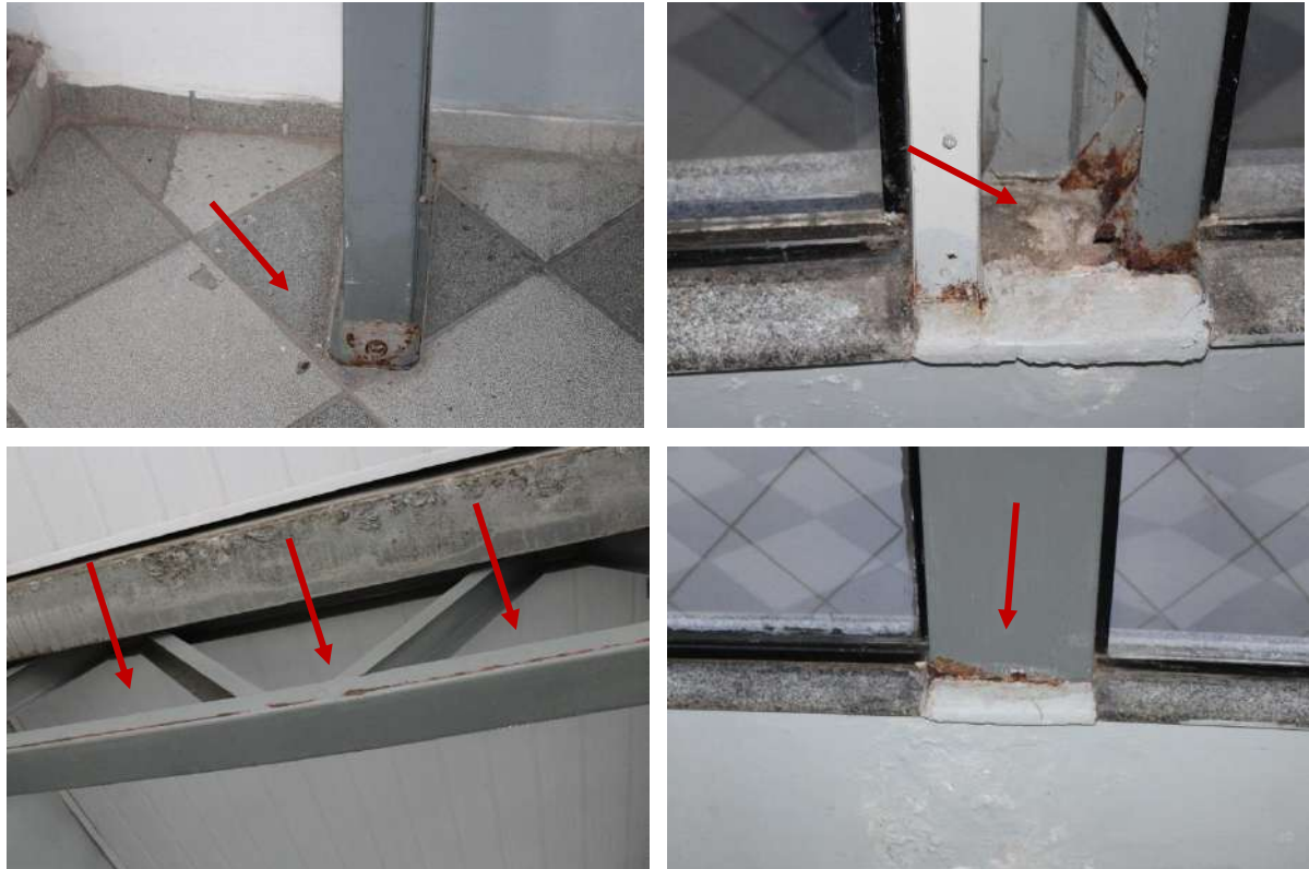
Figura 19 – Sinais de corrosão nas estruturas metálicas da cobertura do pavimento ático
