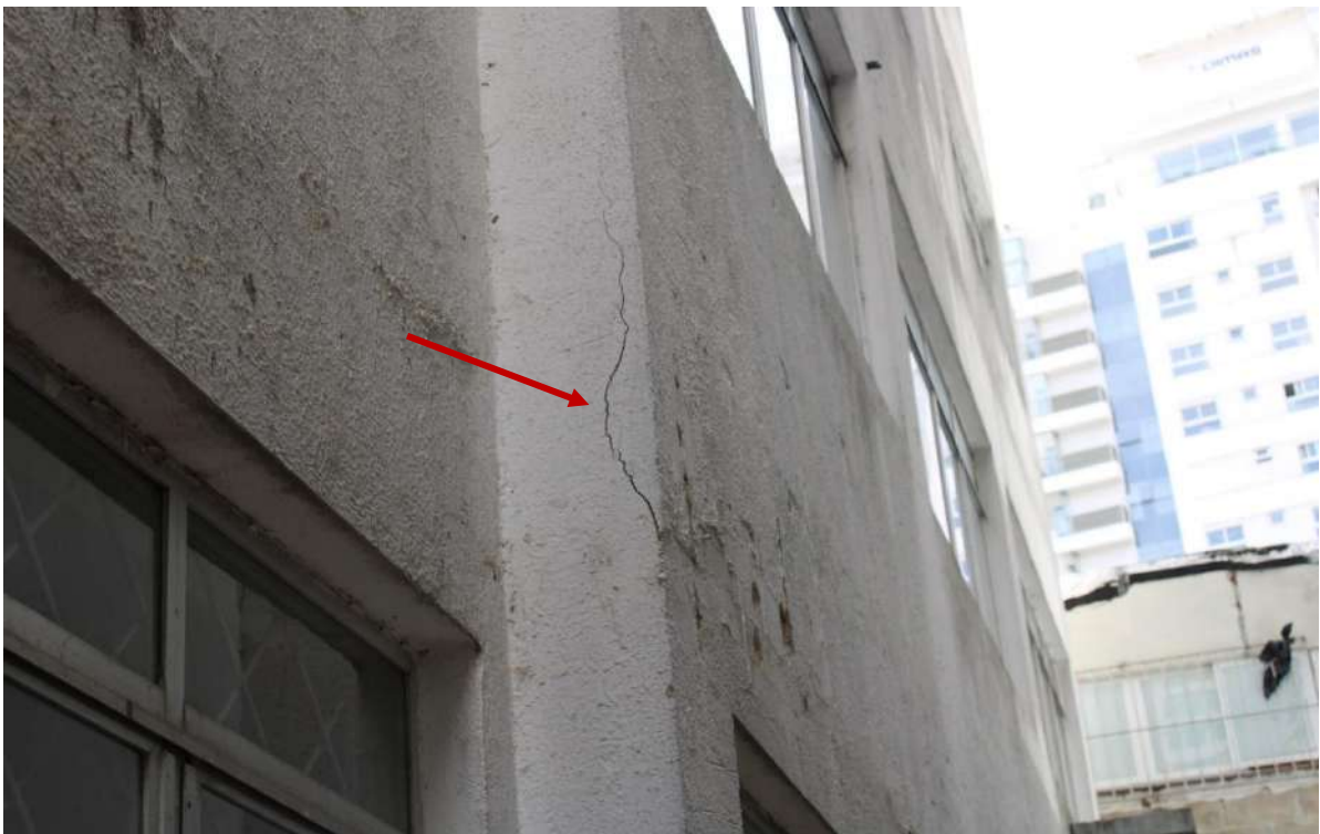
Figura 11 – Fissura característica de processos de corrosão de armadura observada na fachada sul.
