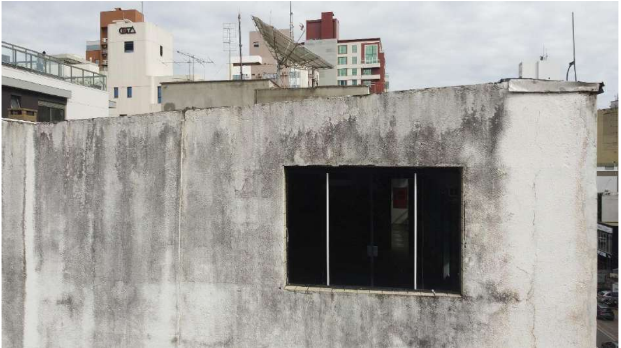
Figura 13 - Vista da porção superior da fachada leste. Nota-se a elevada biodeterioração da pintura, caracterizada pelo manchamento da fachada. Esta anomalia se deu por falta de manutenções no sistema de pintura, sendo agravada pela ausência de pingadeiras no topo da platibanda e sob a esquadria, permitindo a percolação da água diretamente sobre a superfície pintada.
