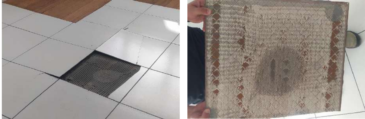
Figura 26 – Peça cerâmica descolada do contrapiso no 1º andar da edificação. Nota-se a falta de argamassa colante no tardo do da peça retirada, evidenciando a incorreta execução do revestimento.
